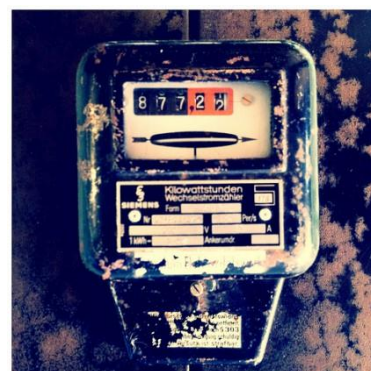
Stromzähler (Foto: WWF)
