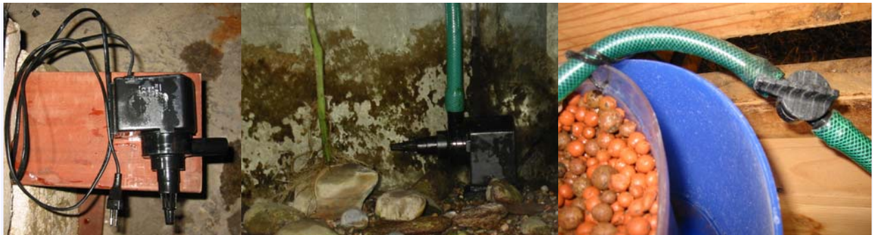
Abb. 9: links, Wasserpumpe mit Netzstecker, Filteraufsatz, damit keine groben Teile eingesogen werden und einem Vorsatz wo der Schlauch übergestülpt wird. mitte , Eingerichteter Aquariumboden mit Wasserpumpe und wegführender Leitung rechts , Leitung mit verstellbarem Wasserhahn, mittels Kabelbinde am Hydrotopf fixiert
