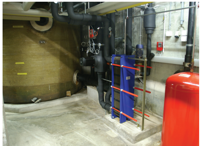
Der Wärmetauscher (blau) nimmt die Wärme aus dem Solar-Kreislauf auf und führt sie dem Grundwasser zu, das im Grundwassertank (braun) gespeichert ist. Foto: B. Vogel
